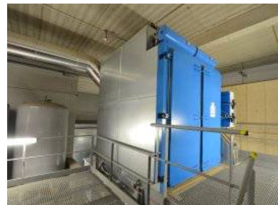
Le filtre à manches Tecfidis installé après la chaudière à rafle de maïs Compte R. à la chaufferie Eco 2 Wacken, photo FD
