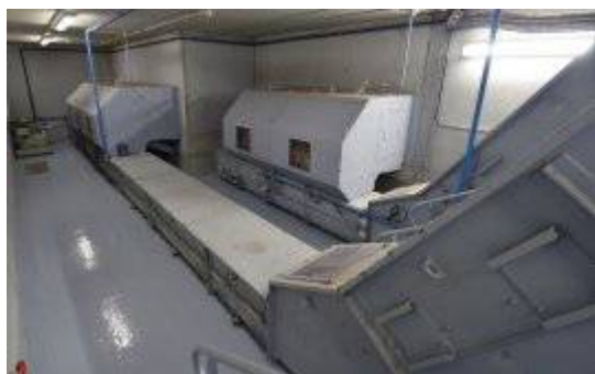
L'extraction et le convoyage de la rafle de maïs se fait avec des équipements conventionnels à bois, comme ici à la chaufferie du Wacken, photo FD
