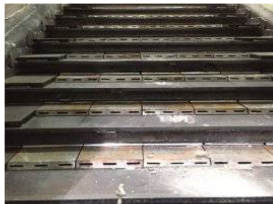
La grille refroidie Compte R. telle qu'installée dans les chaufferies d'Antigone ou du Wacken, photo Compte R
