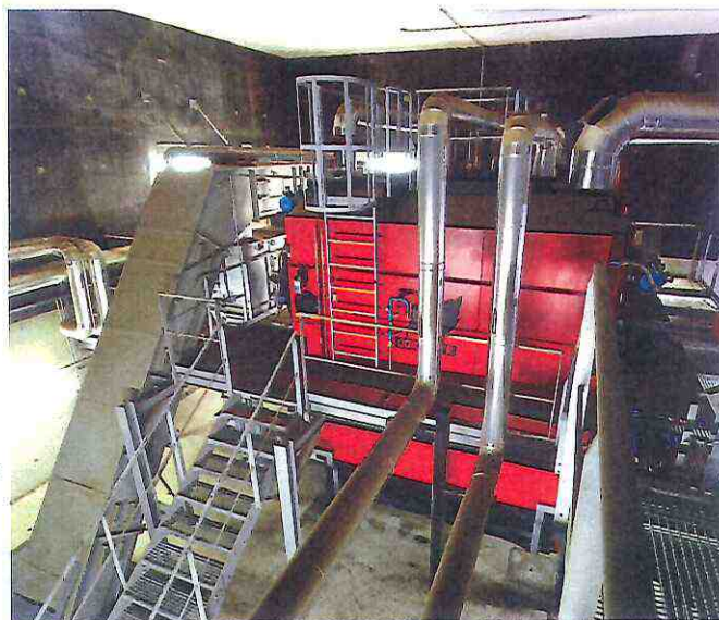
Vue sur l'une des chaudières bois de Canto-Perdrix, photo FD
