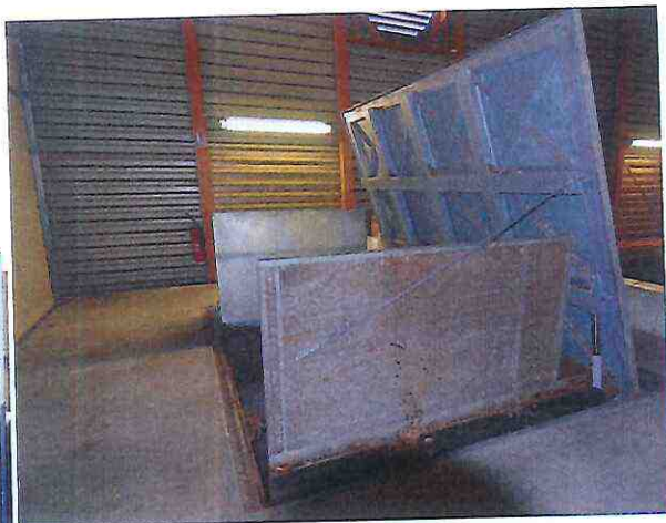
L'une des deux trappes carrossables pour la livraison du bois, photo FD
