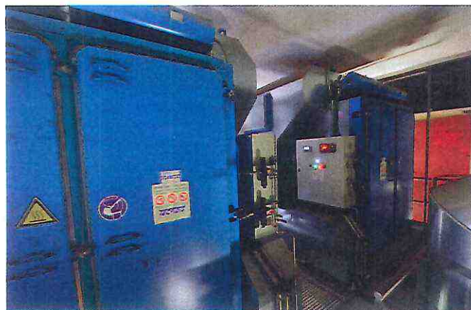
La partie haute des deux filtres à manches TECFIDIS installés à la chaufferie bois de Canto-Perdrix, photo FD
