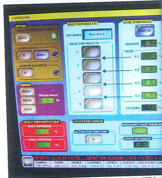
Le menu de régulation de la chaudière COMPTE R. n° fonction de l'humidité du combustible, photo FD
