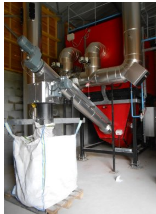
Évacuation des poussières d'un filtre à manches COMPTE.R, photo COMPTE.R
